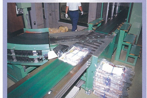
集合ベルトコンベヤ Collective belt conveyor
