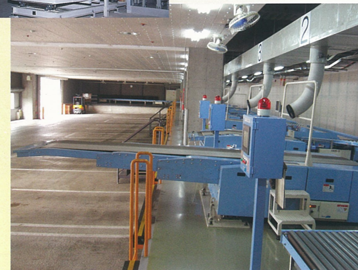
トラックゲート全景 Overall view of Quick-Sort system
