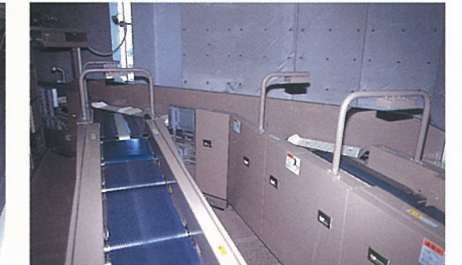
インダクション Upper surface of induction system
