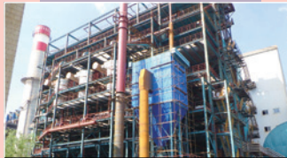
脱硫脱硝設備 (製鉄所) バケットエレベータ
