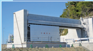
防潮水門 ケーブルベヤ
